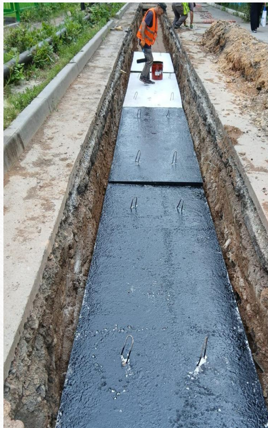
п.1. от ул.Т.Шонанулы 41/1 до теплового узла ул.Т.Шонаулы,28
